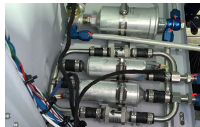
Die bestehende Installation von Benzinpumpen und -filter konnte für den Rotax 912iS unverändert übernommen werden L'installation existante des pompes et filtres à essence a pu être reprise telle quelle pour le Rotax 912iS.
